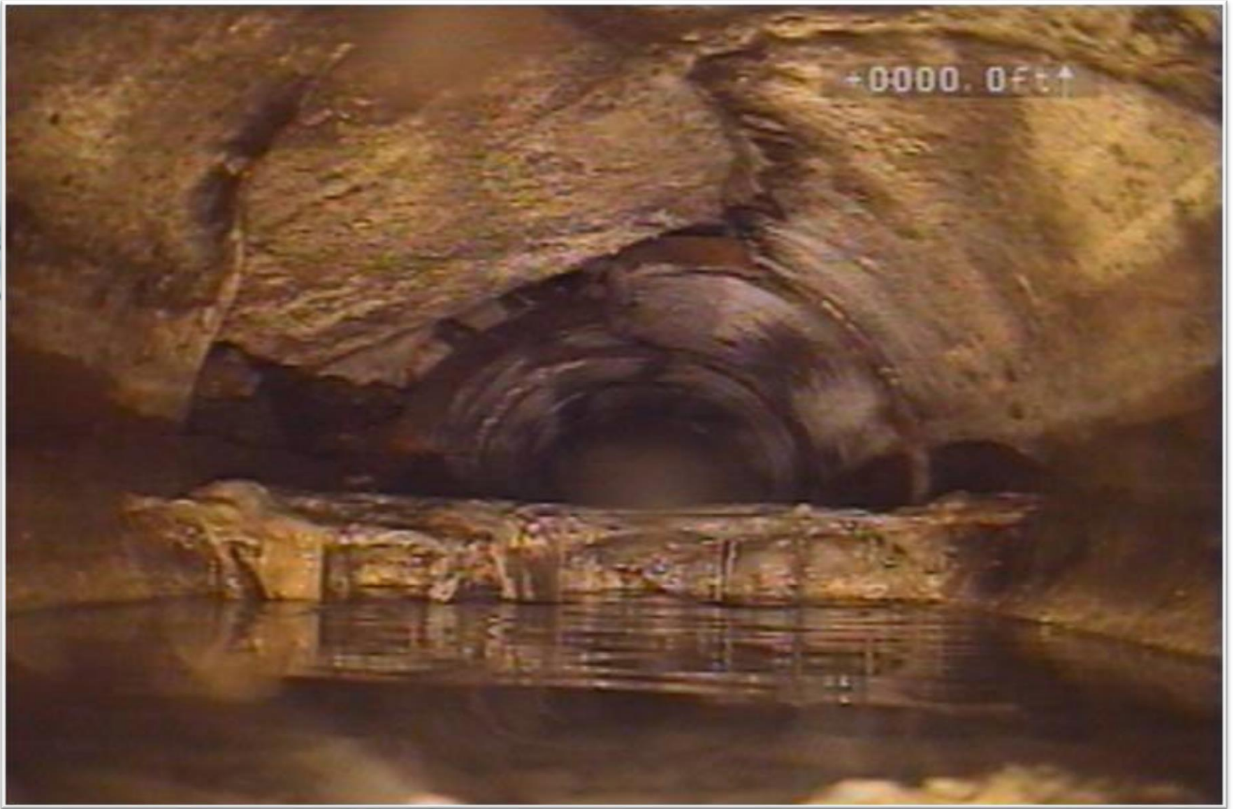
Colapso de la parte superior de la tubería del colector Montevideo, Colonia Lindavista, Deleg. Gustavo A. Madero.
