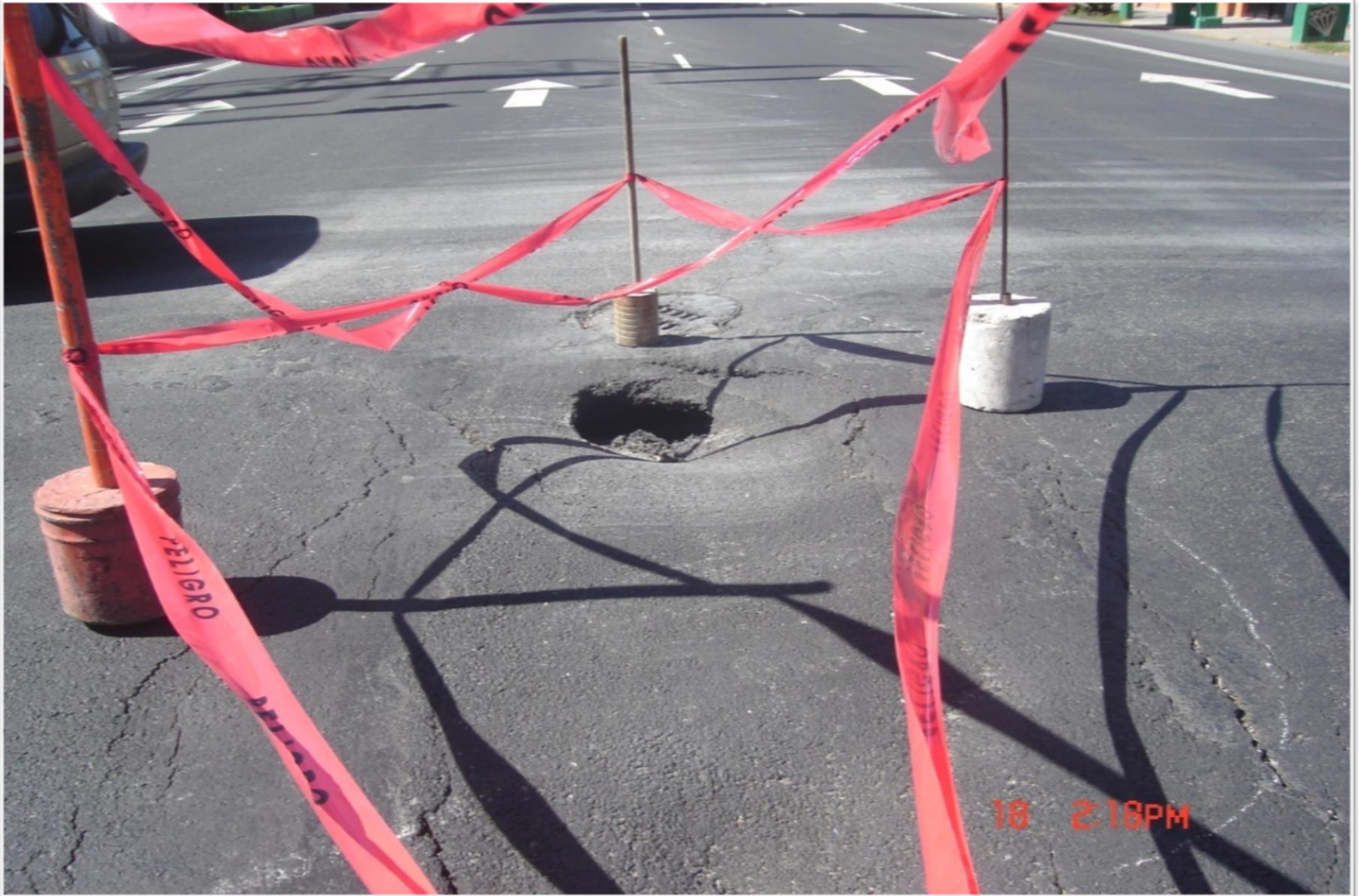
Hundimiento de terreno en vialidad por afectación del colector Montevideo, Colonia Lindavista, Deleg. Gustavo A. Madero.
